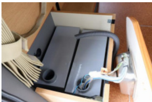
給水、排水タンク
